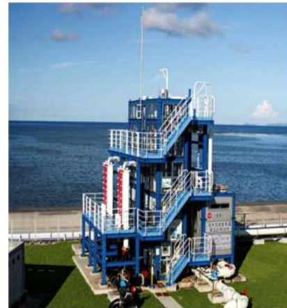
図4 海洋温度差発電実証プラント (100kW 級：沖縄県久米島)
