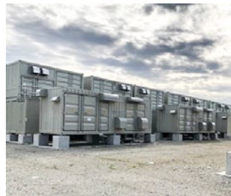
2022年8月筆者撮影 「系統側蓄電池による風力発電募集プロセス(I期)」のレドックスフロー蓄電池
