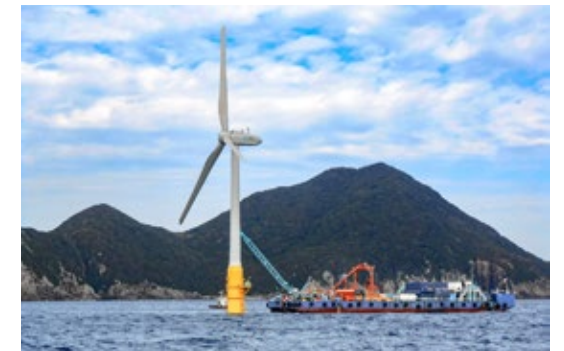
設置海域で、係留チェーン及び海底ケーブルを取り付けて設置完了となる 出典元: 戸田建設株式会社 崎山沖 2MW 浮体式洋上風力発電所パンフレット
