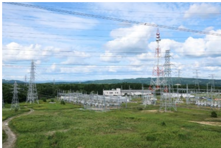
2022年8月事務局撮影 南早来変電所
