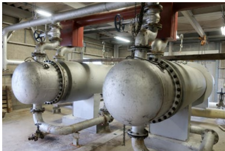
2022年8月事務局撮影 森町熱交換器室
