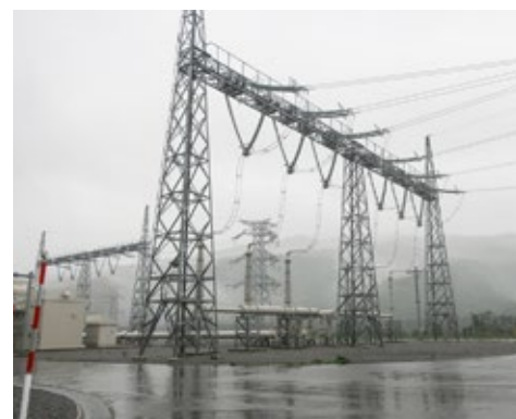
2022年8月事務局撮影 北斗変換所
