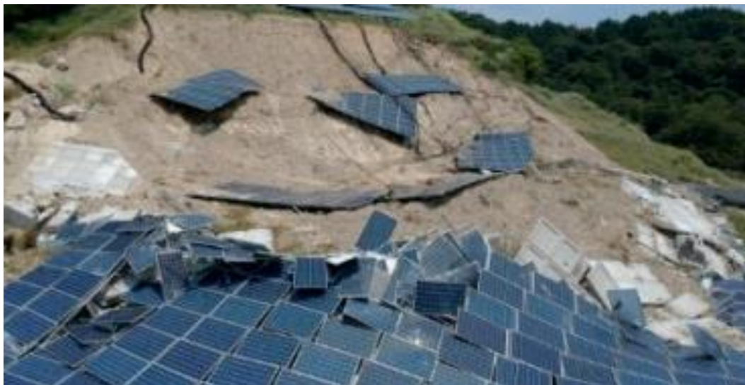
災害に起因した太陽光発電設備に係る被害例
