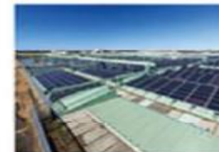
下水処理場の上部空間を活用した太陽光発電
